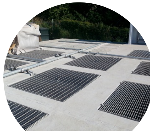
CELDA DE TRATAMIENTO DE AGUAS NEGRAS
