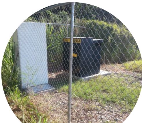
SUBESTACIÓN ELÉCTRICA Y CONTROLES
